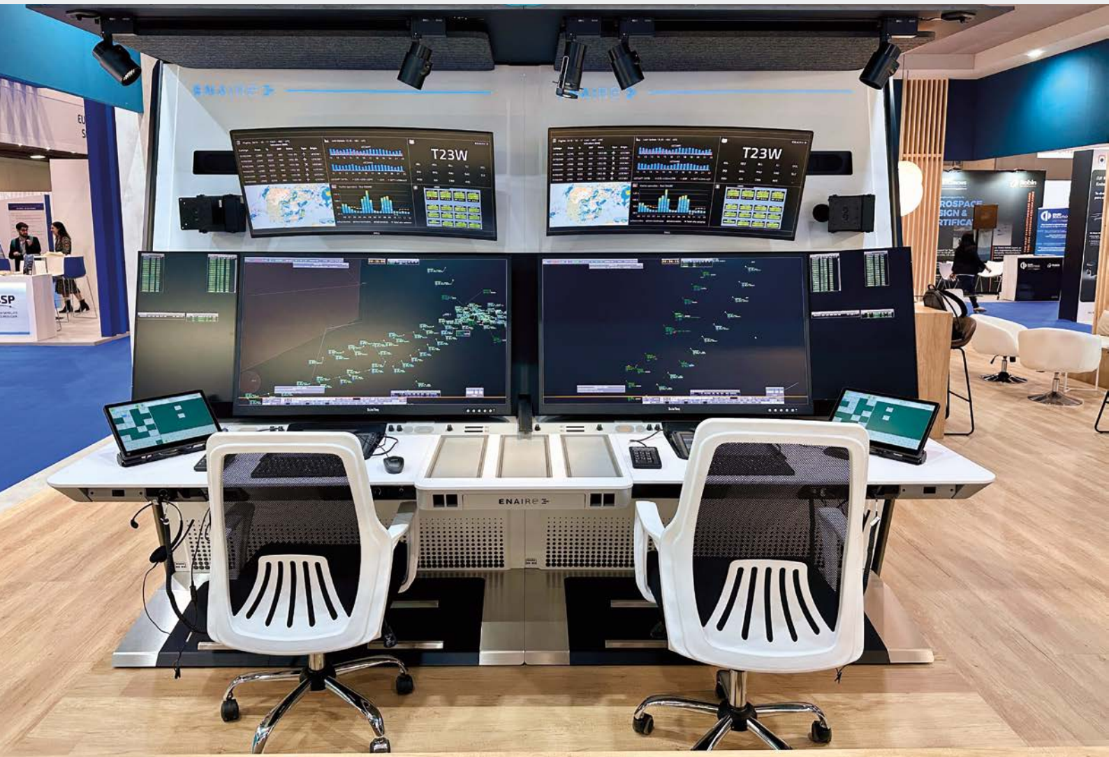
Neues ATM-System von INDRA.
